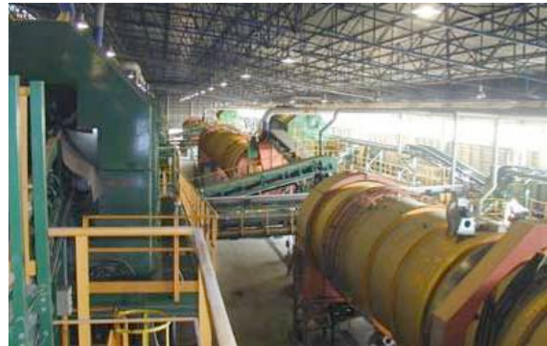
Εργοστάσιο μηχανικής ανακύκλωσης και κομποστοποίησης στα Άνω Λιόσια
