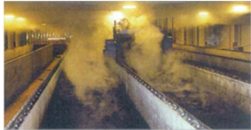
Κλειστό Σύστημα κομποστοποίησης σε Δεξαμενές
