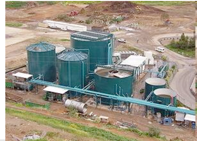
Εγκατάσταση αναερόβιας χώνευσης
